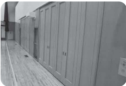
修理が必要な収納扉
