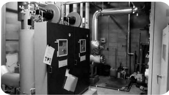
総合センターボイラー
