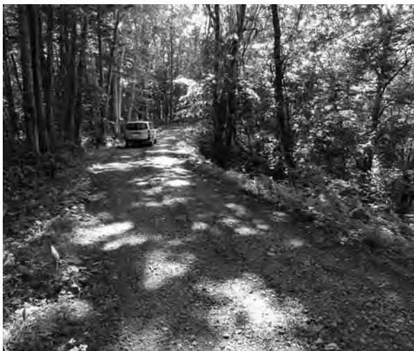
村道東1線の地割れ復旧状況
