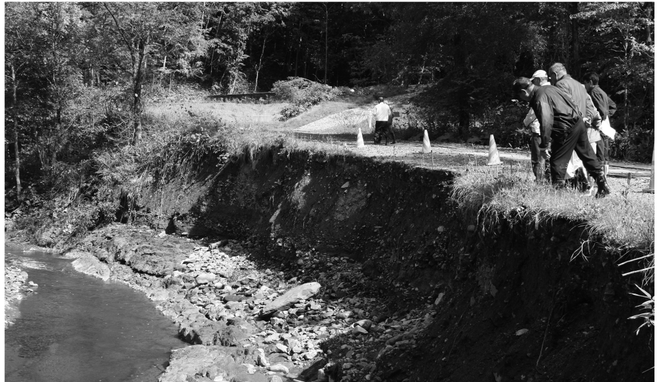
村道二ニウ1号線 被災状況
