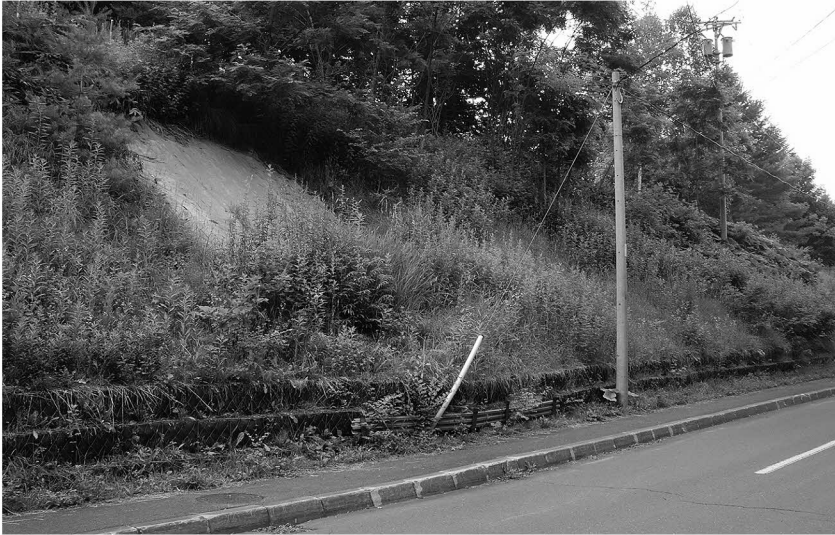
中学校通学路の崩落部分
