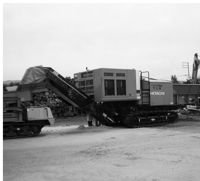
木質原料製造施設（下川町）
