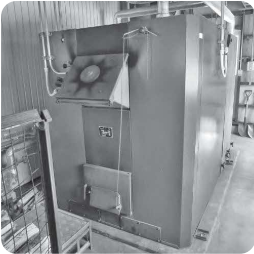
湯の沢温泉ボイラー
