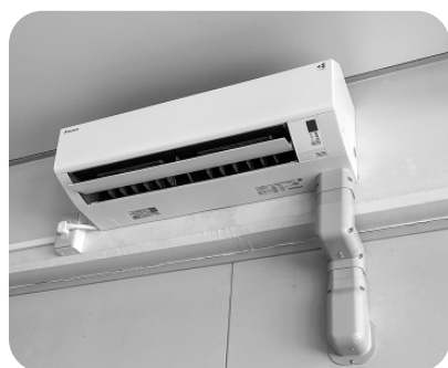
学校に設置されたエアコン
