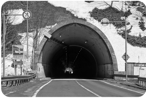
改修が望まれる金山トンネル
