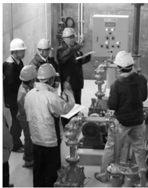
上トマムポンプ場内で説明を受ける
